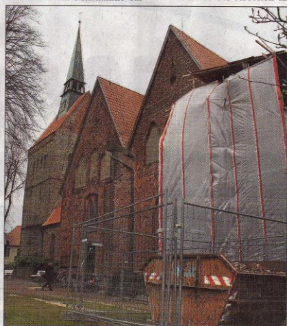
HINTER der Bauplane können die Sanierungsarbeiten an Dachstuhl und Mauerwerk auch im Winter vorangehen.
